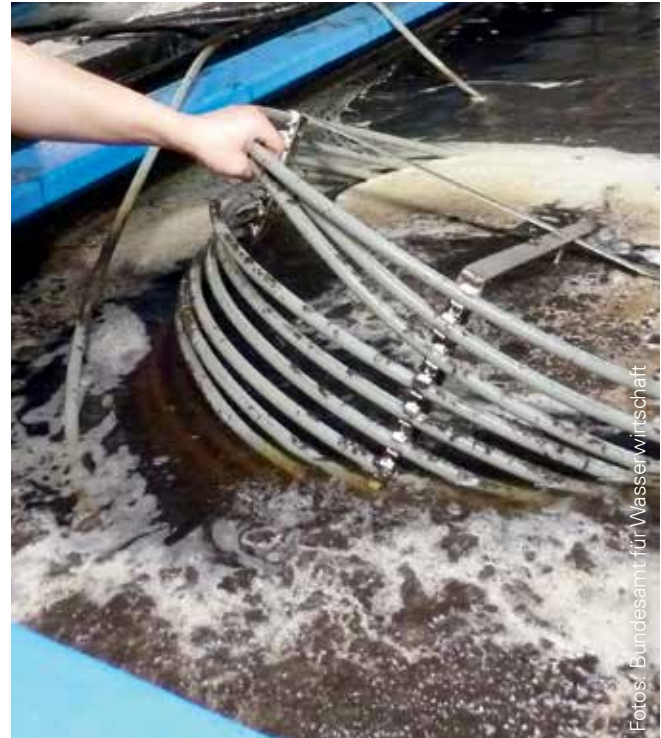
Wärmetauscher zum Nachheizen im Pumpensumpf
